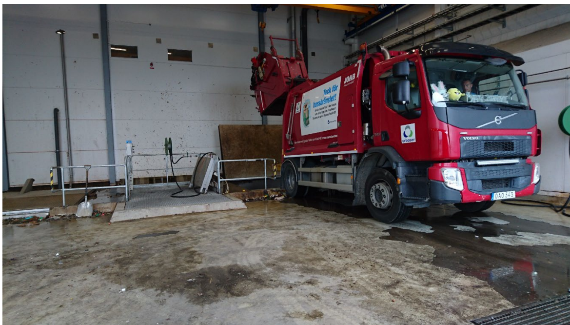
Figur 2. Mottagningshall anläggning A. Luckor försluter tippfickor före/efter tippning.
