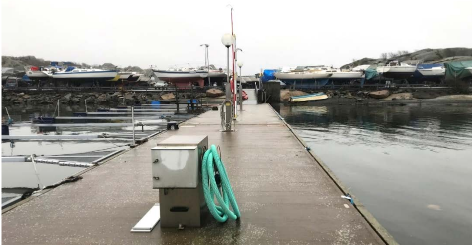
Figur 1.2: Exempel på toatömningsstation. Saltholmen november 2019. Foto: Karl Jivén.
